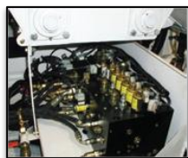
Control del Sistema Hidráulico
