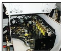
Control del Sistema Hidráulico
